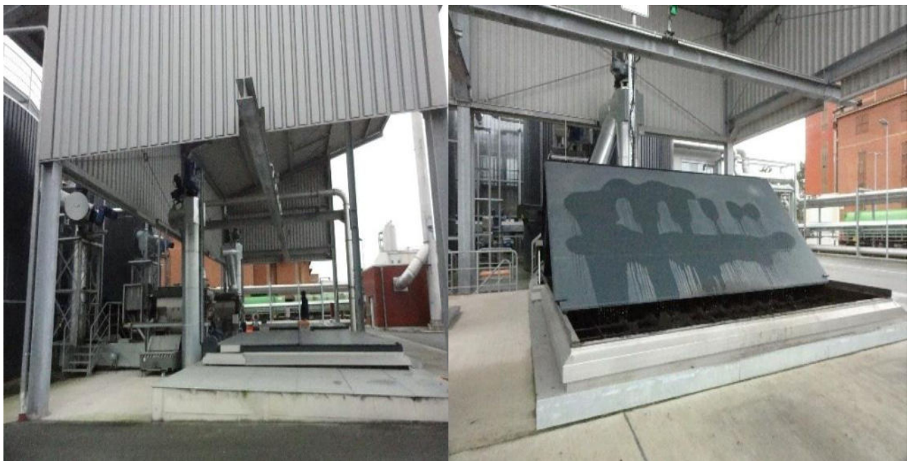
Abbildung 5-2: Beispiel einer Annahmestation / -bunker einer Klärschlamm-trocknungsanlage.
